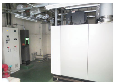
貫流ボイラ運転台数の最適化
