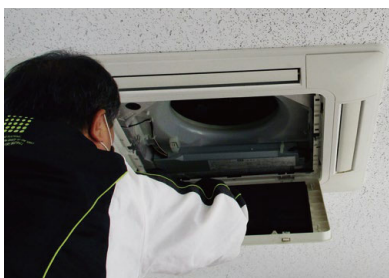
エアコンフィルターの清掃
