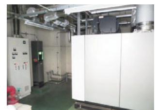
貫流ボイラ運転台数の最適化
