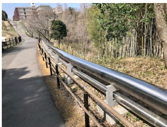
⑫歩道上へ倒れる危険がある竹の伐採
