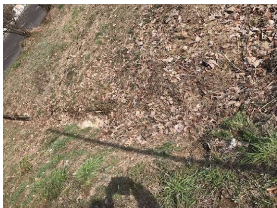
⑭土砂に埋もれた側溝
